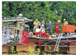
Verletzten Arbeiter von Dach geborgen Notarzteam und Antif Feuerwehreinheit versorgen und bergen einen 20-jährigen Arbeiter einer Raufirma, der Mittwoch auf einem Baudach in Anif schwer verunglückte war. Der Mann war ausmüdet, auf ein stehendes Blech gestürzt und hatte sich eine schwere Kränkeverletzung zugezogen. Er wurde ins UKH gebracht.
